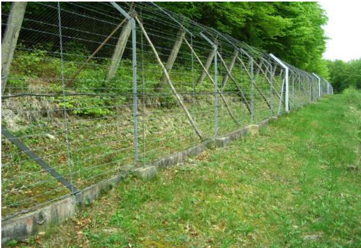
Pohľad na nachýlené vonkajšie oplotenie
