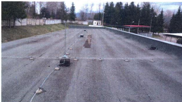
Pohľad narušenia strešnej krytiny:
