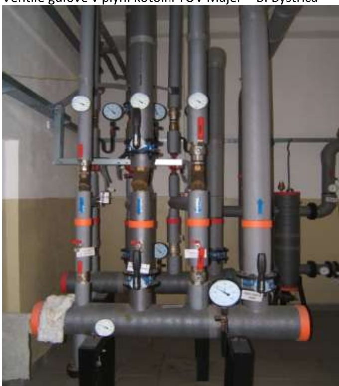
Ventile guľové v plyn. kotolni TOV Majer – B. Bystrica
