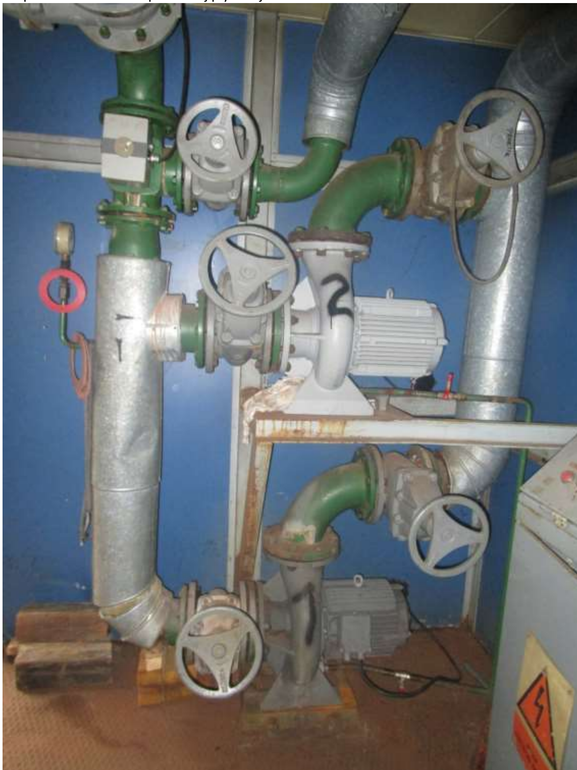
Čerpadlo obehové ÚK v prevoznej plynovej kotolni K SNP Podborová - Zvolen
